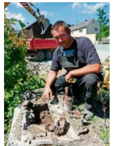
Polier Norman Spranger von der Baufirma WTU aus Weischlitz zeigt den Fund im Hohlraum des Fundamentes vom Kriegerdenkmal.
