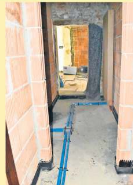
Heizungsrohre am Boden
