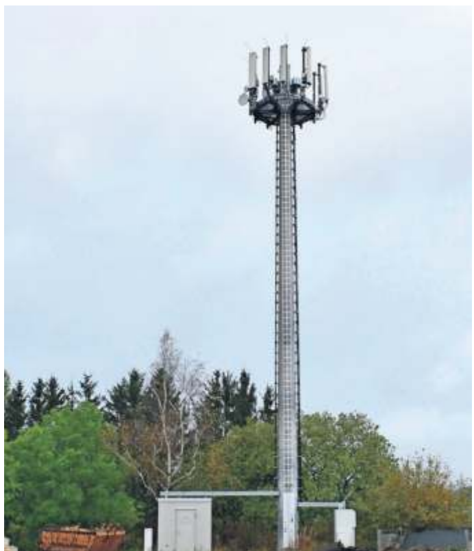
Mobilfunkmast am Stadtbauhof
