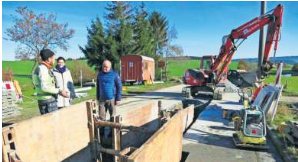
Polier Woldemar Buchmüller von der Firma Tief- und Ingenieurbau GmbH Weischlitz (TIW) erläutert die Baumaßnahmen für die Kanalsanierung in Schnarchenreuth. Mit im Bild Bürgermeisterin Patricia Rubner und Landtagsabgeordneter Alexander König.
