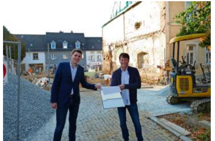
Bürgermeister Kristan von Waldenfels (links) und Bauherr Dr. Martin Süß werfen einen Blick in die Pläne. Im Hintergrund die Baustelle.
