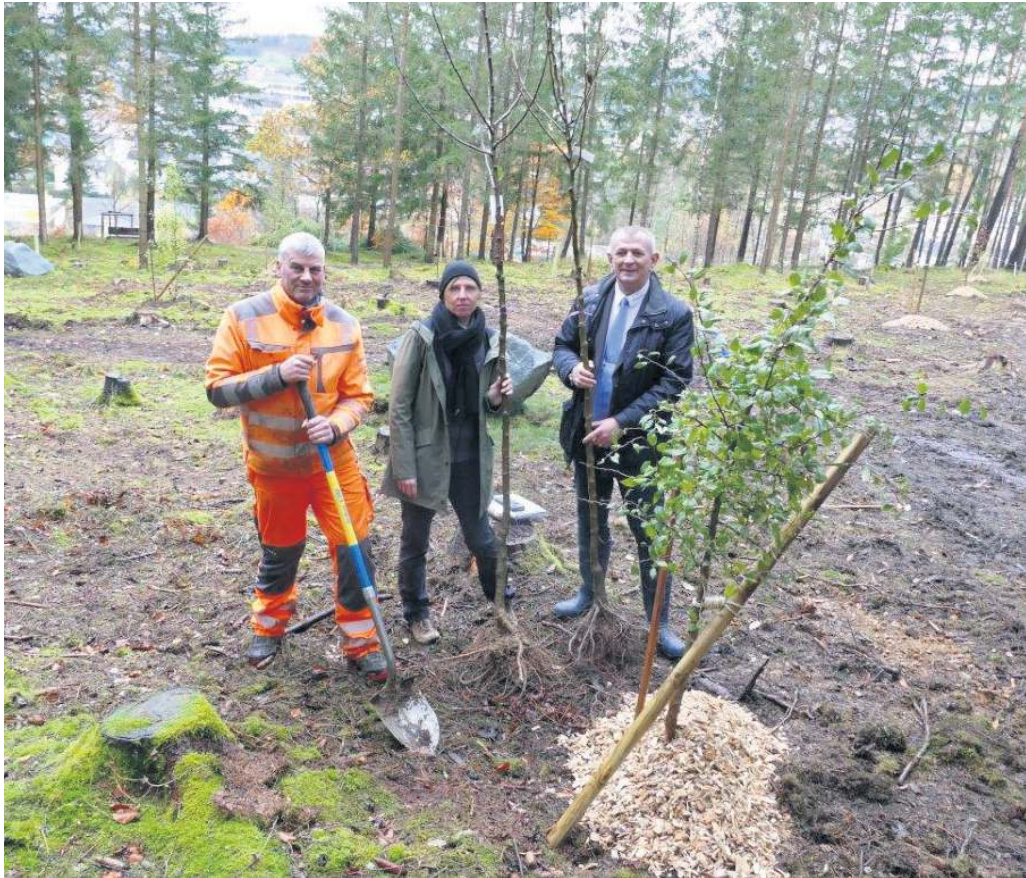
Auf dem Wald- und Naturfriedhof entsteht eine Erweiterung, eine Streuobstwiese, Laubbäume und Findlinge. Unser Bild zeigt bei den Pflanzarbeiten (von links) Vorarbeiter des Grünanlagenpflege- trupps Siegfried Deffner, Mitarbeiterin der zuständigen Reitzensteiner Land- und Forstwirtschafts GmbH, Nina Burjakow-Schneider und 1. Bürgermeister Frank Stumpf.
